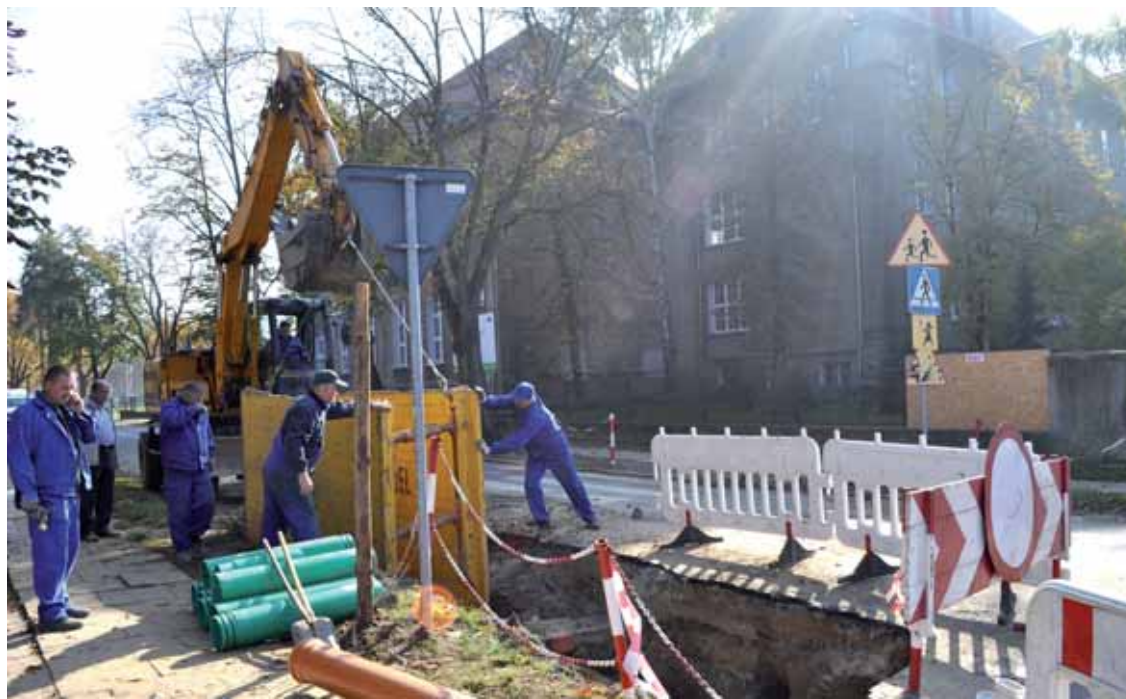
Ruszyły roboty kanalizacyjne bardzo dużej gminnej inwestycji wspieranej środkami unijnymi. Zakończenie planowane jest na koniec 2012 roku
