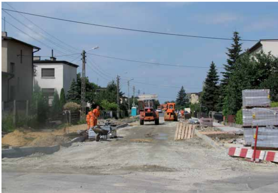
Ulica Samulskiego w Krotoszynie także zmieniła swój wizerunek w ostatnich latach. Tu: w trakcie inwestycji
